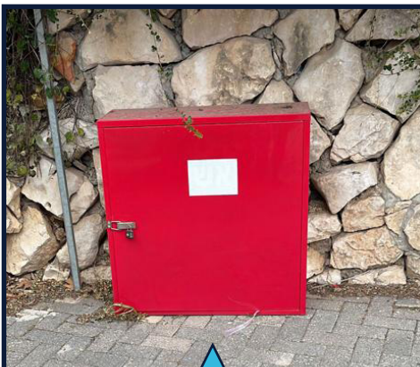
התקנו 32 ארונות כיבוי אש מזוודים בקו בתים ראשון למתן מענה ראשוני על ידי התושבים
